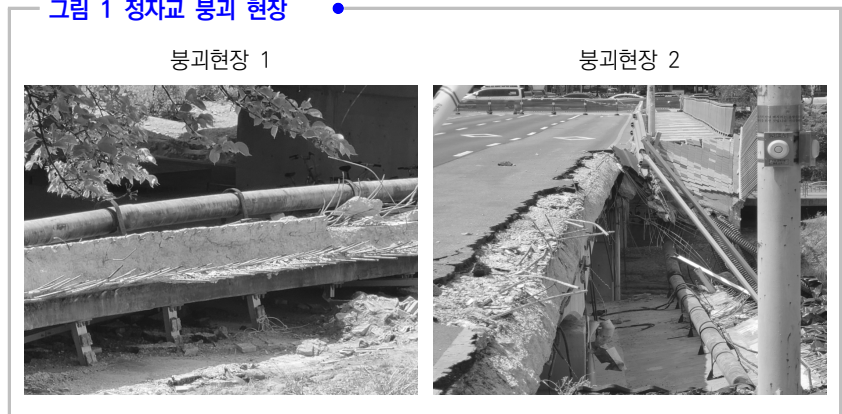
그림 1 정자교 붕괴 현장
